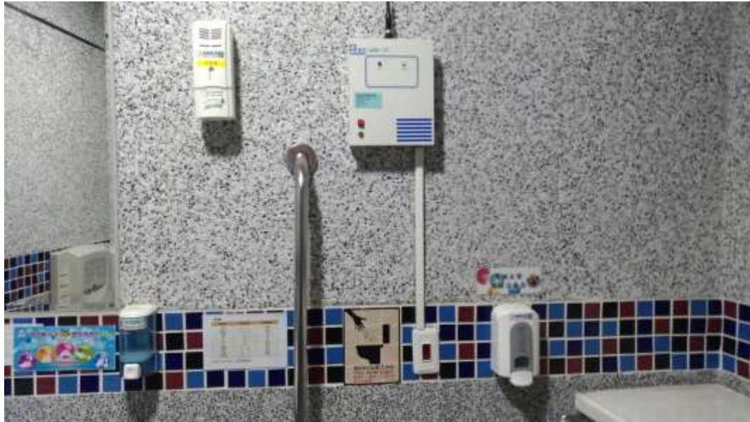
緊急按鈕及相關消毒設備
